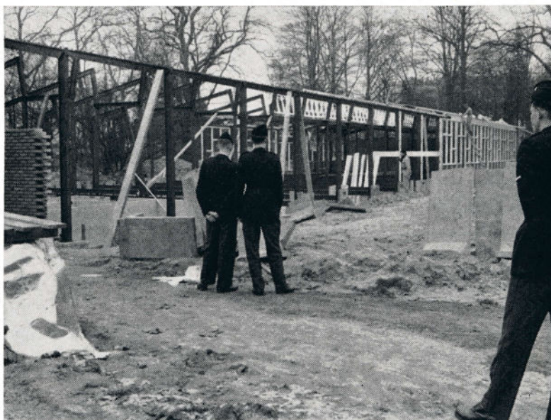
Op het terrein van de Opleidingschool wordt hard gewerkt aan de bouw van twee paviljoens: één bestemd voor de kaderopleiding, het andere voor de recreatie van 300 aspiranten. (Foto: Wachtm. 1e kl. J. B. Plompen)
